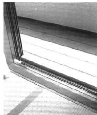
⑥少しの段差でも、車いすの移動に支障をきたし、高齢者のつまずきの原因にもなる。廊下と部屋、部屋と部屋の間の段差をなくし、ベランダには部屋の床レベルに合わせてすのこを敷いた。
