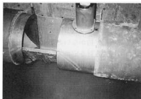
図3.22 マンホール内の流量測定装置
