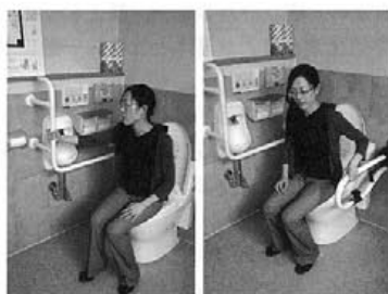
図1 動作補助手すりの例（トイレ）。L型手すり（左）・可動式手すり（右）
