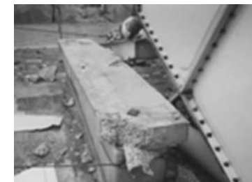
図2 コンクリート基礎のコーナー部が破損
