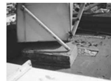
図6 梁形コンクリート基礎の転倒
