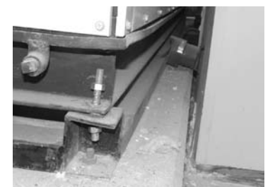
図10 防振装置が外れストッパーが変形
