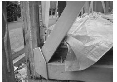
図5 まだまだ多い悪質な改修事例
