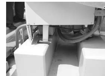
図3 機器の脚部が変形
