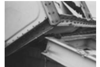
図1 アンカーボルトの抜け
