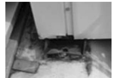
図4 アンカーボルトで機器のベース部材が破断
