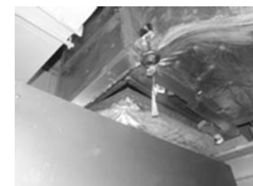
図9 空調機からのキャンバスダクト接続部の破断
