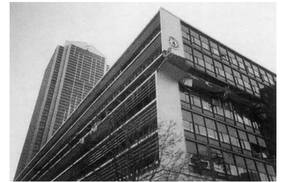
図2 中間階で層崩壊した例 1)
