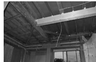
図3 解体後2階床梁の不足が判明したため追加補強
