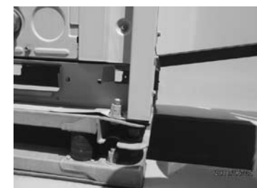
図5 機器のベース部材が変形し防振架台も変形
