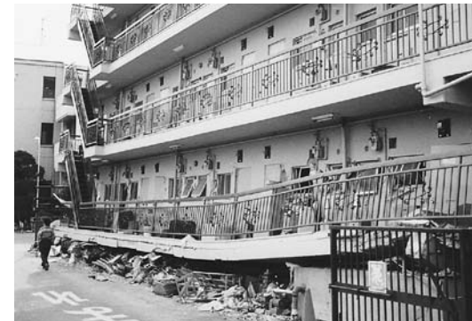
図1 1階ピロティ部で層崩壊した例
