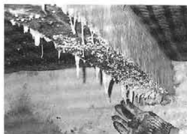
図3-3-5 b 結露の害の例 (ナミダタケ被害)
