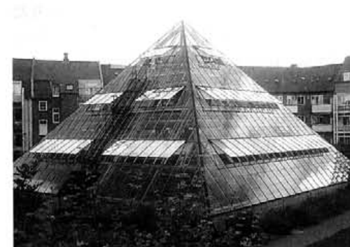
写真1-4-3 集合住宅中庭に設置された植物による汚水浄化プラント（バイオワークス） デンマーク、コーリング。雨水貯留水は便所洗浄水として利用され、住宅内汚水は一次貯留された後、ガラスのピラミッド内のため池で植物浄化され、最後は地下に浸透処理される
