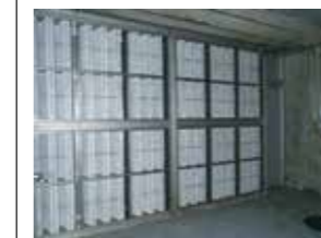
給気口に設けた塩害フィルタ。*
